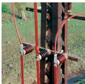
Isolierung der senkrechten Ableitungen an einer Gittermast-Station mit BPTM-Schäuchen
