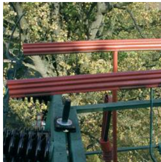
Mit OLIC-C abgedeckte Rundkupferverbindung an einem Gittermast
